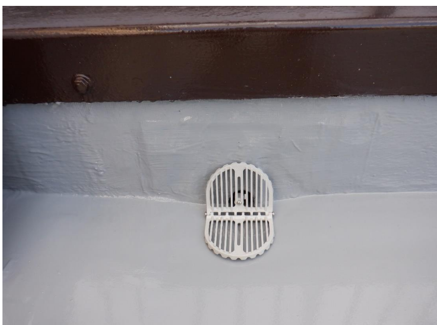
ストレーナーキャップ 取付状況
